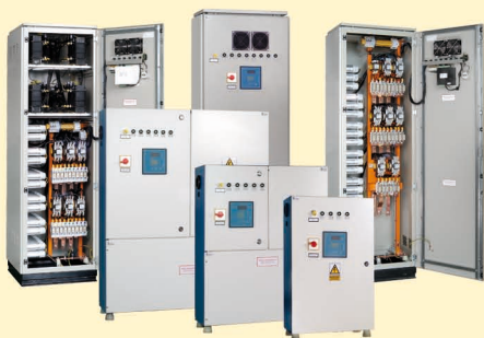
BK – T – 95 baterie kondensatorów mocy
